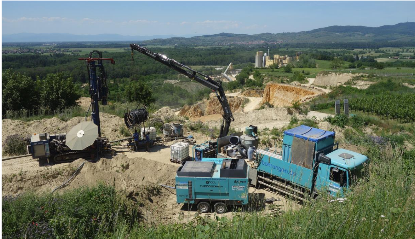
Bohrarbeiten im Steinbruch 06/2021 & 06/2022 Erstellung von EWS in ca. 13 m mächtiger Lössbedeckung, darunter Kalkstein
