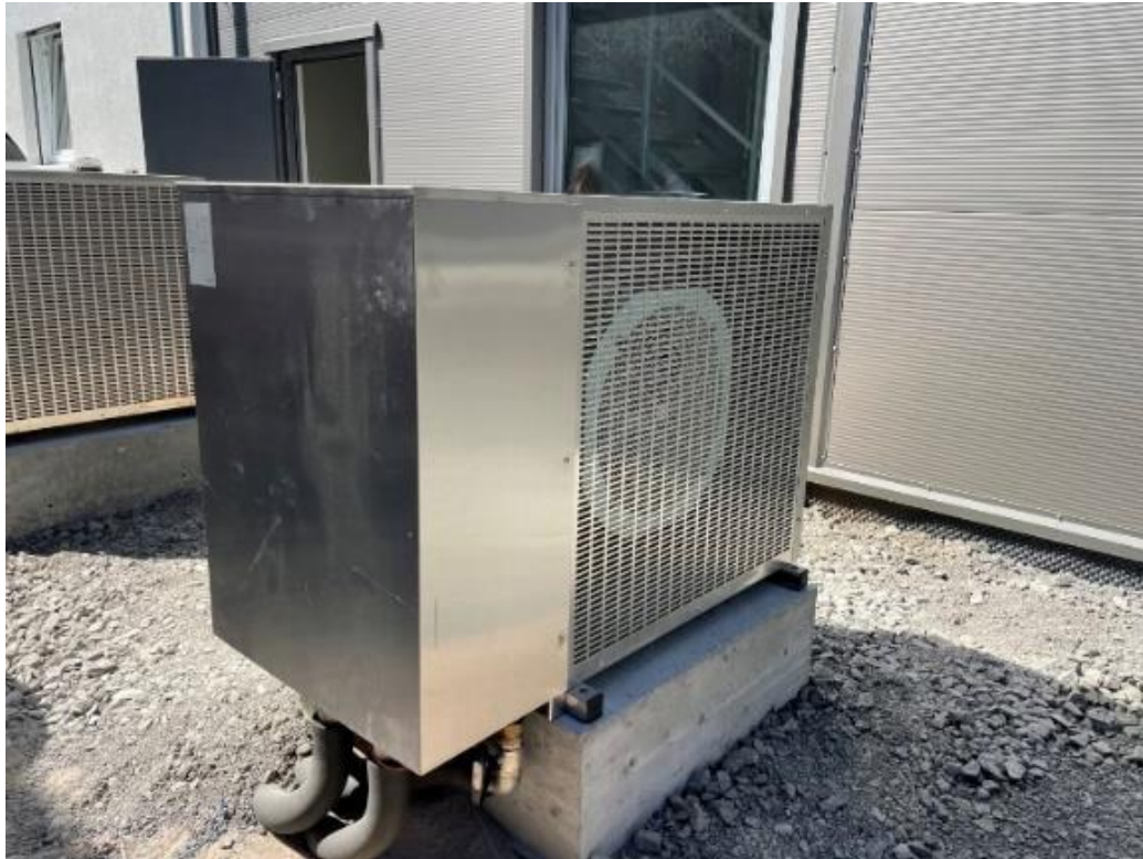
Eigenes Foto, Terra Booster am Standort Schönaich
