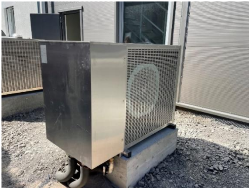
Eigenes Foto, Terra Booster am Standort Schönaich
