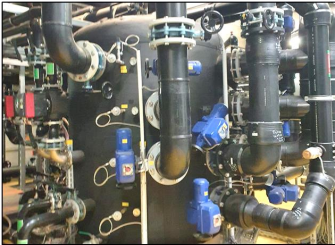
Am Standort in der Halle 18 im VW Werk Emden umgesetzter „flinker Speicher“
