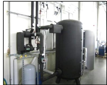
Hochtemperatur- speicher (2 m 3 + 900 l) Kältespeicher (2 m 3 )
